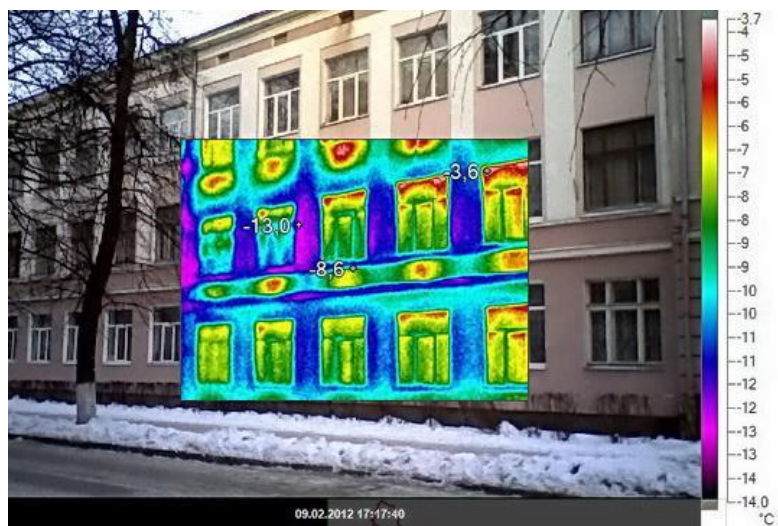
Рисунок 2.6 — Результати тепловізійного контролю температури зовнішньої стіни огороження будівлі
